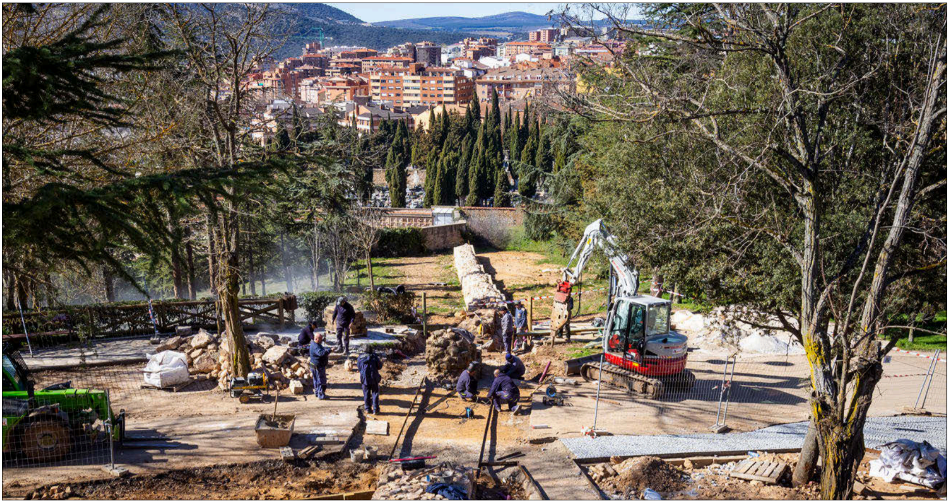
Vista de los trabajos en la zona y al fondo una parte de la ciudad. MARIO TEJEDOR
